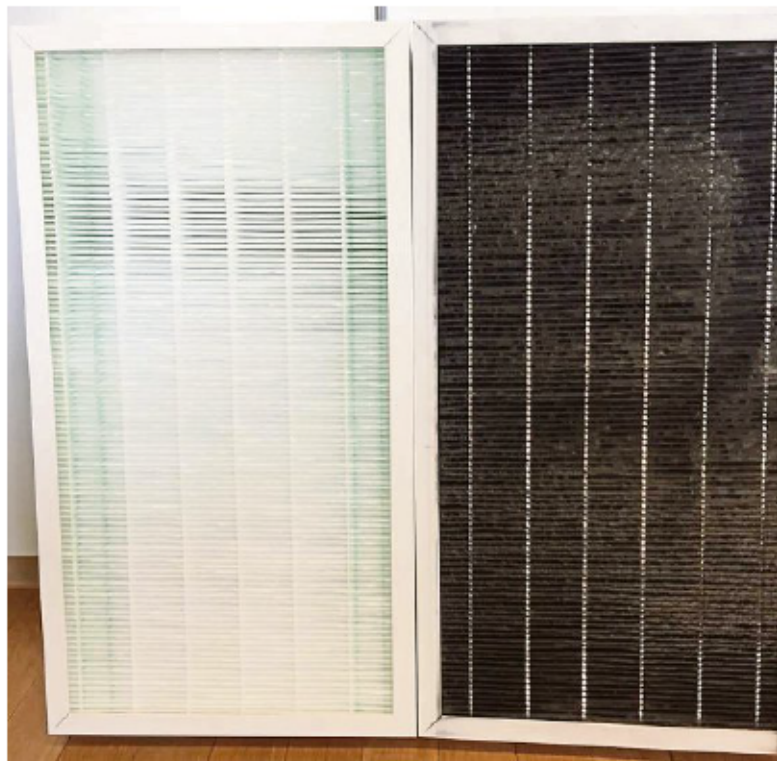
Aus Weiß wird Schwarz: Der Luftfilter der Klimaanlage vor dem Einbau und nach wenigen Wochen. FOTO: PRIVAT
