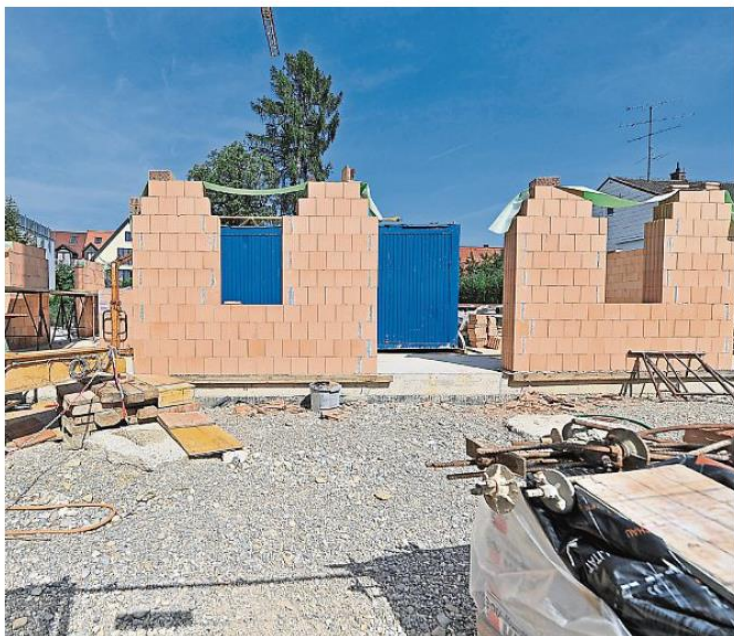
Bilder von der Baustelle: Das Erdgeschoss des Mehrfamilienhauses ist noch nicht komplett gemauert
