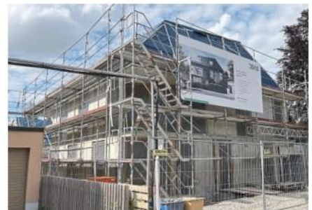
Der Rohbau für das „Effizienzhaus“ in der Ittisstraße (Waldtrudering) steht seit Juli 2022. Fünf Familien sollten hier einziehen.
