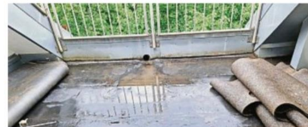
Wasser unter der Dämmfolie: So schaut es auf der Dachterrasse der tz-Leserin aus. Foto: privat
