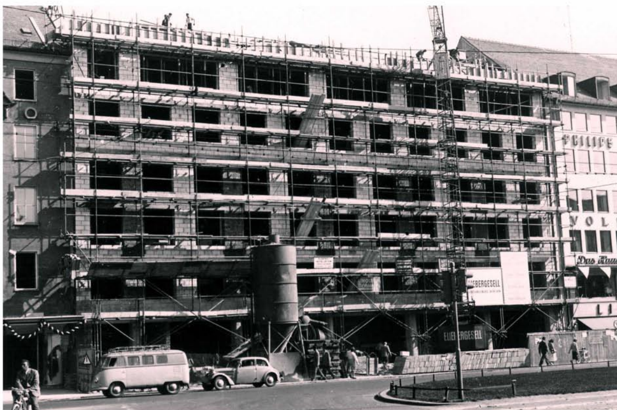
Der Aufbau des Anwesens Sonnenstraße 13 ist bis zum Dachstuhl vollendet; Foto vom 19.9.1959
